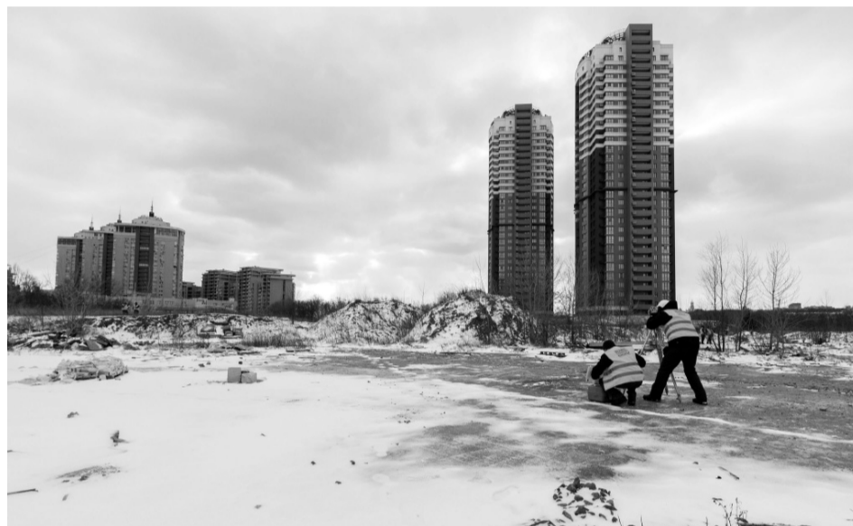
До кінця 2024 року на цьому столичному будмайданчику, розташованому на лівому березі Дніпра, має з'явитися 15-тисячний багатофункціональний спортивний комплекс. Фото з сайту fbu.ua.
